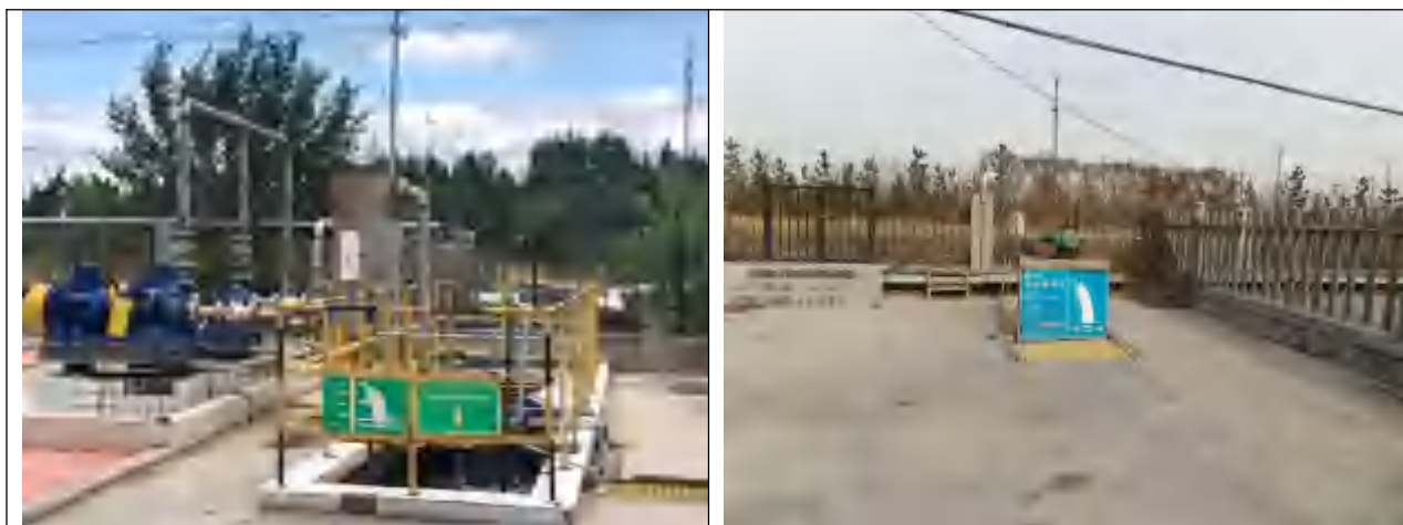
污水总排口和雨水排放口
